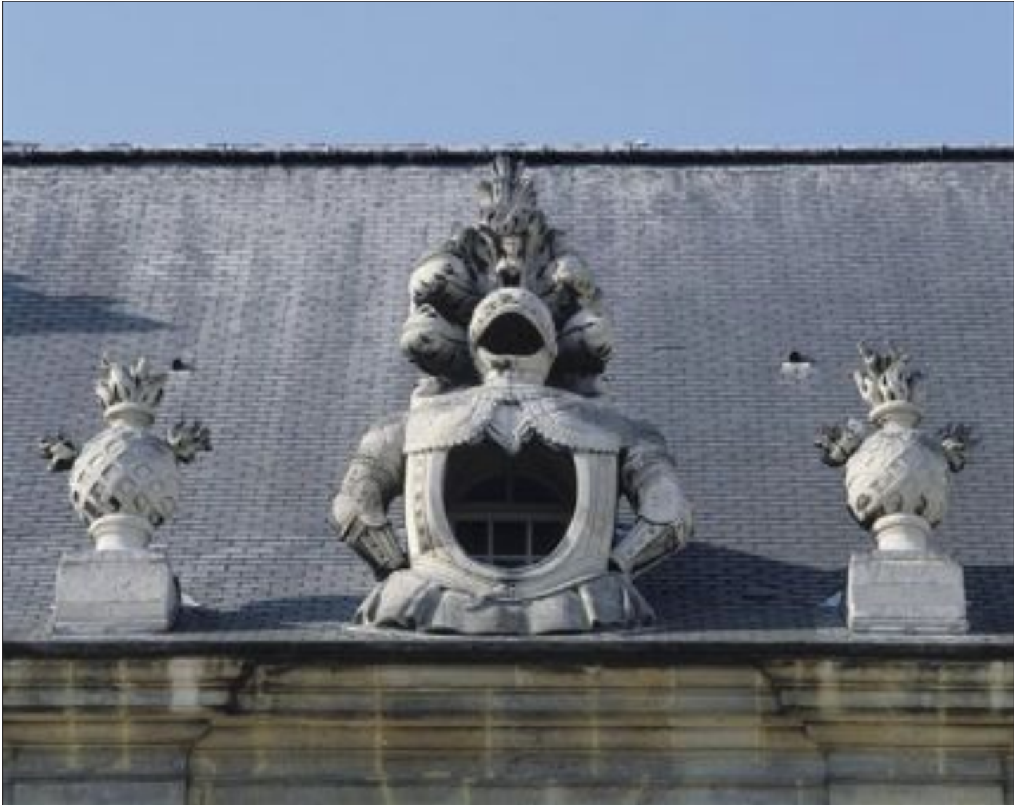
Lucarne et pots à feu sur les toits de la façade nord de l'Hôtel des Invalides © Paris, musée de l'Armée/RMN-GP 96-011056.
